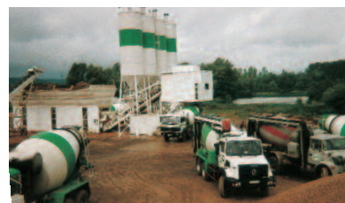
Centrale à béton.
