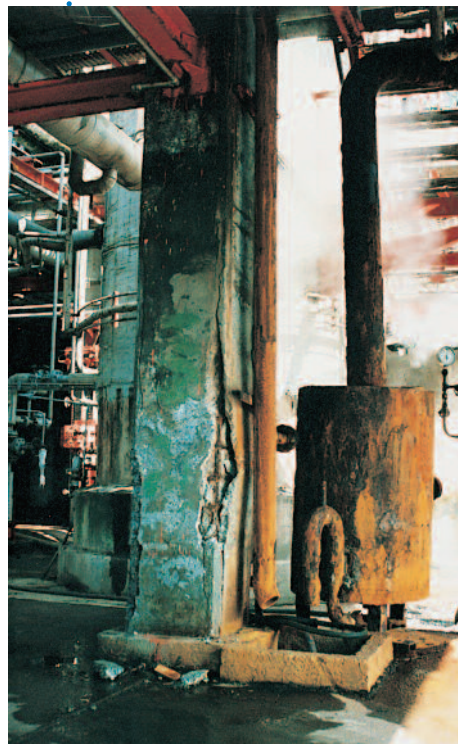
Corrosion d'armature (milieu industriel)
